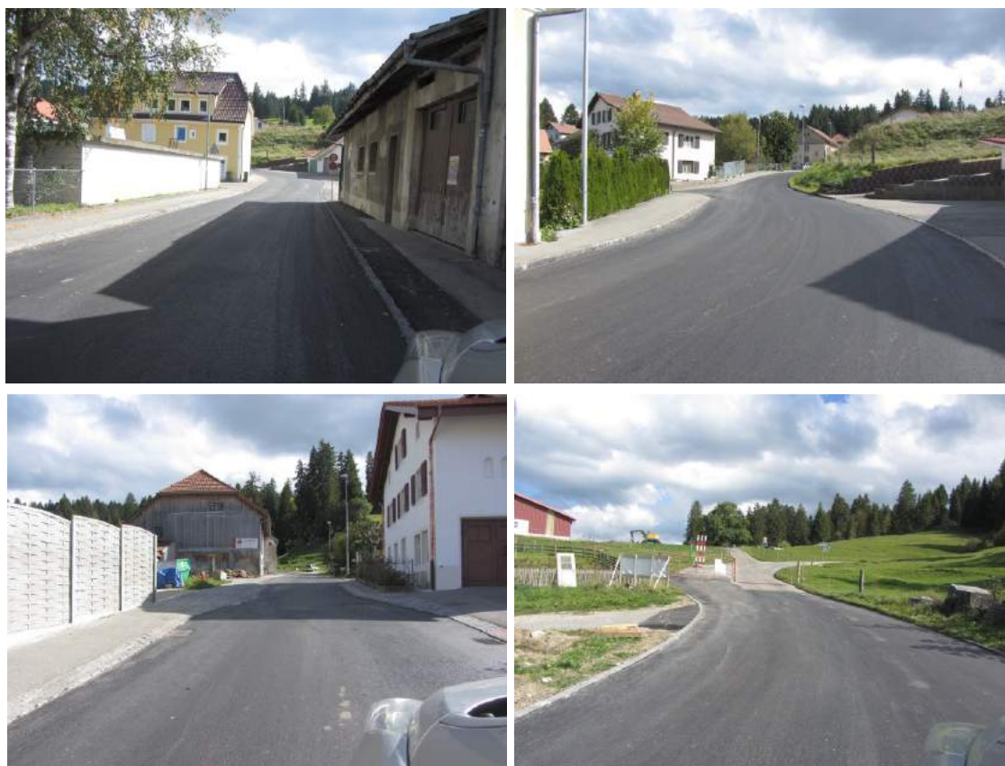
Figures 24 : Route de Jeanbrenin après sa dernière réfection (état 25.09.2017)
